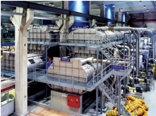
Fig. 4.40 Voith EcoCell installation (source: Voith).
