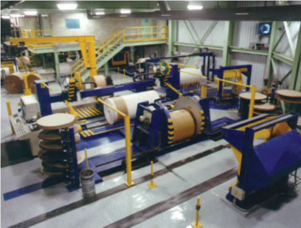
Fig. 8.12 Spiral wrapping machine (source: Voith).
