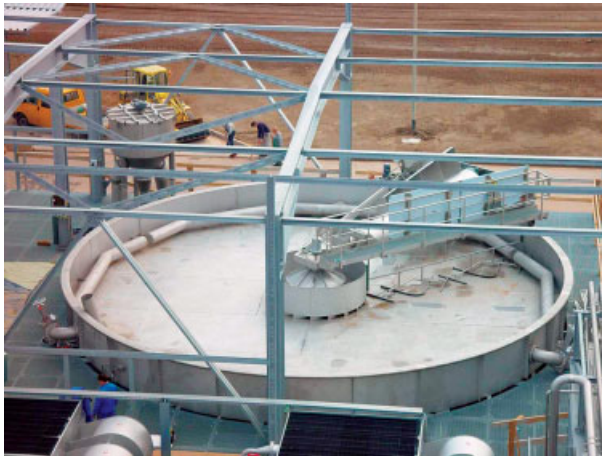
Fig. 4.42 Air flotation tank (source: meri Entsorgungstechnik).
